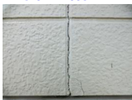
シーリングひび割れ
