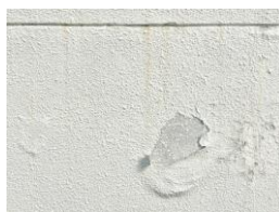
塗膜剥離、浮き
